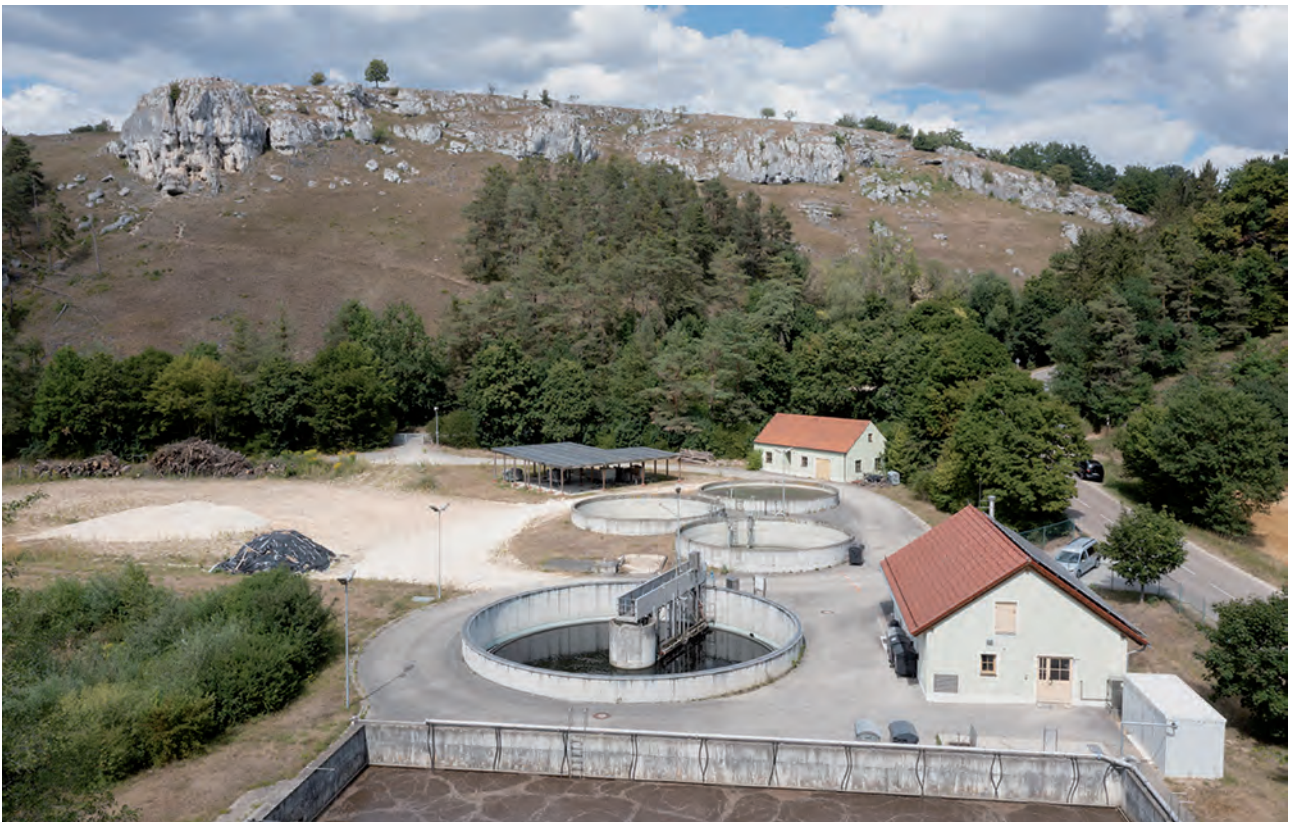
Kläranlage Eilsbrunn am Fuße des „Alpinen Steigs“, 2022
